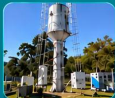
INFRAESTRUTURA 4G Estação Rádio Base
